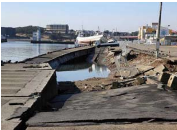
津波により護岸に乗り上げた漁船と陥没した岸壁
